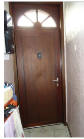
onvoldoende opstelruimte aan de slotzijde van de deur
